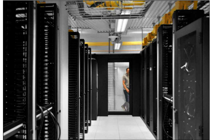
El diseño de Arquitectura Abierta soporta la Contención de Pasillos Calientes y permite más equipos.
