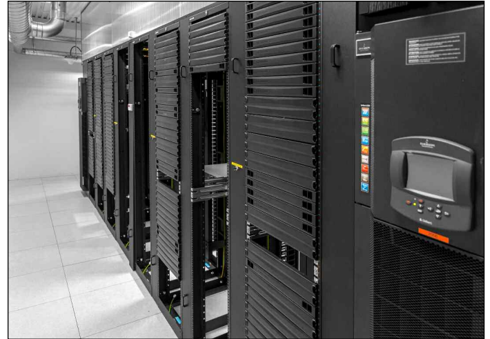
El centro de datos de vanguardia de SpareBank 1 les da la flexibilidad necesaria para enfriar el equipo y mantener la continuidad de las operaciones.
