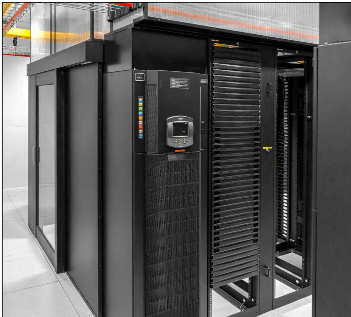
Administración de cables Evolution ®, Bastidores de Cuatro Postes QuadraRacks , Sistemas de Puertas de Contención de Pasillo y Arandelas de Cepillos se utilizaron para construir una solución flexible que pueda ser montada en el sitio.
