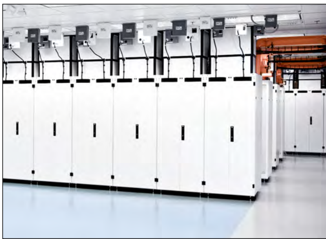
部署 CPI Passive Cooling® 解决方案的 F 系列 TeraFrame® 机柜
