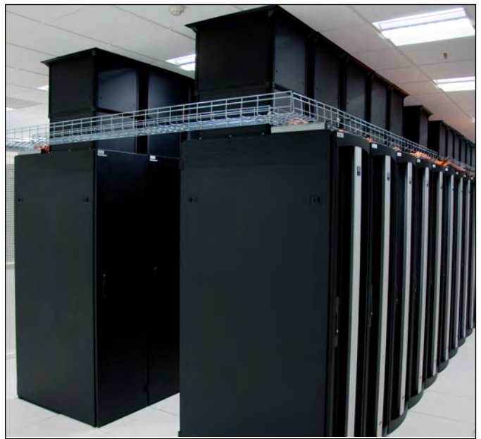
他们为 5,000 平米的数据中心选择了 CPI 的 F 系列 TeraFrame® 机柜系统。
